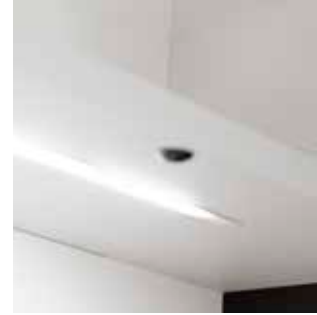
Energieeffiziente LED-Beleuchtung im Innenraum.
