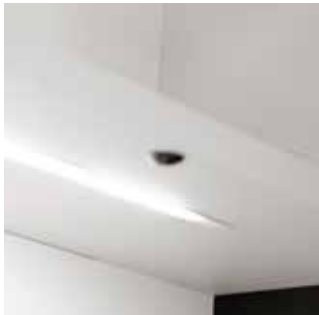
Iluminación interior LED de bajo consumo.
