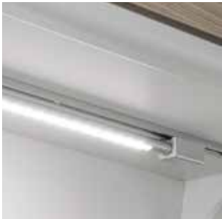
Iluminación interior LED de bajo consumo.
